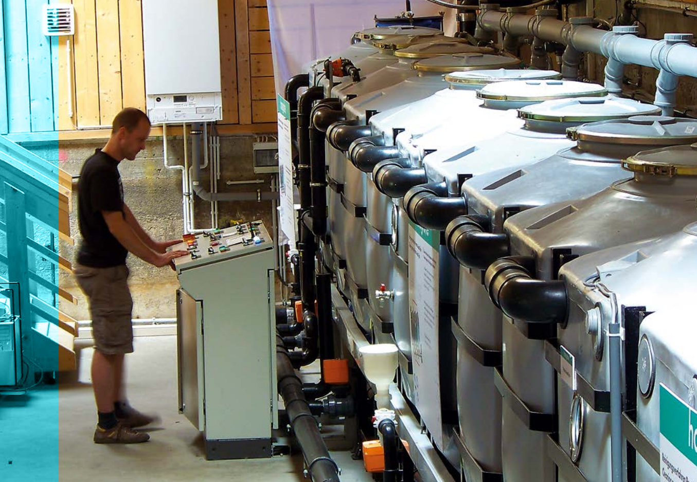
Abb. 3: Blick auf die mehrstufige Grauwasserrecyclinganlage im Block 6. Quelle: Nolde & Partner
