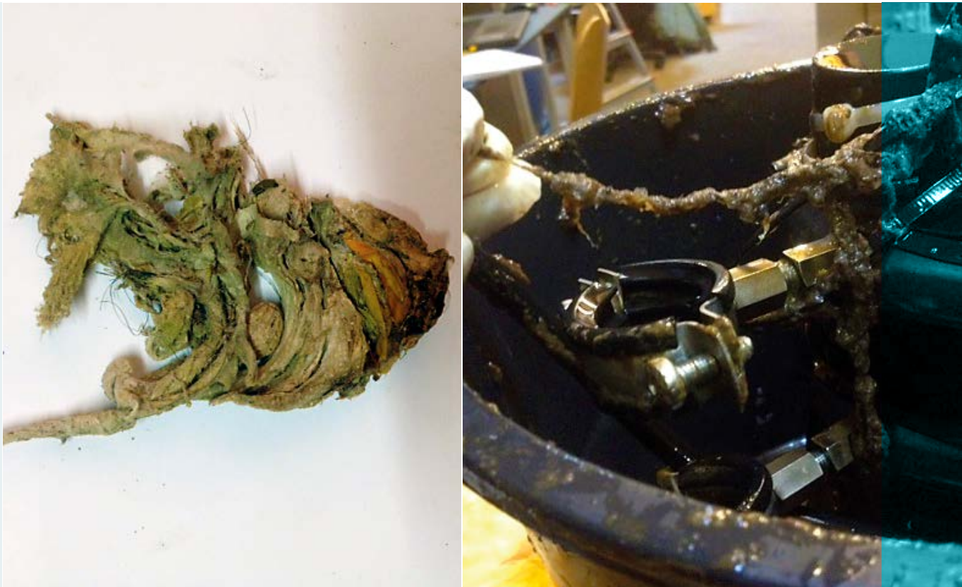
Abb. 4: Pfropfen aus Reinigungstüchern (l.), Verstopfungen im Anlagenzulauf (r.), Quelle: Fraunhofer UMSICHT
