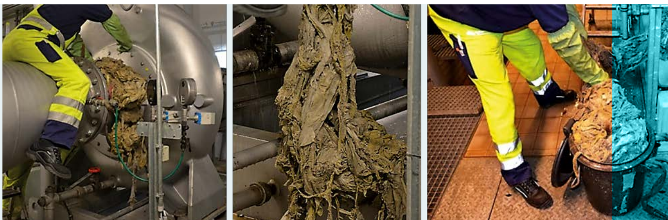
Abb. 1. Beispiele von Pumpenzöpfen – Konglomerate von pumpenverstopfenden Materialien, die zum großen Teil aus Feuchttüchern bestehen. Quelle: Projekt KURAS
